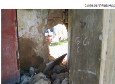
Buraco no muro foi causado após explosão
