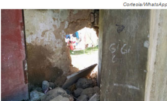
Buraco no muro foi causado no dia 9 de maio
