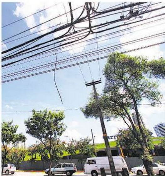
PERIGO Fiação elétrica é aérea e traz riscos quando se parte
