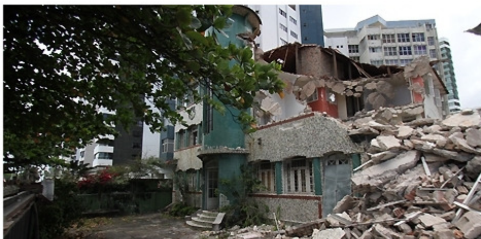
Edifício começou a ser demolido na última sexta e provocou muita polêmica
