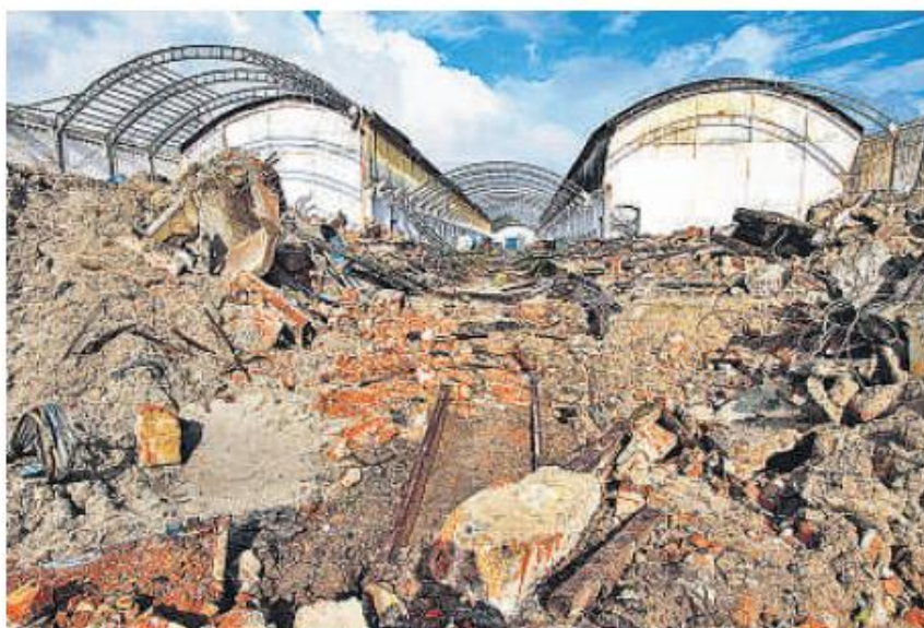
AREA CENTRAL Demolição dos armazéns no Cais começou dia 21 de maio e foi interrompida
