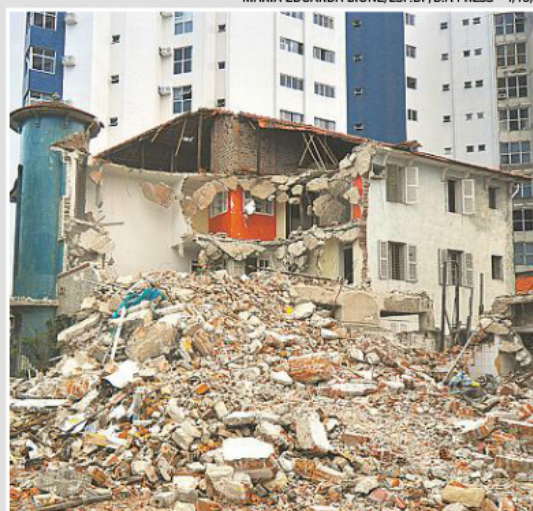
Parte do prédio estilo neocolonial já foi destruída
