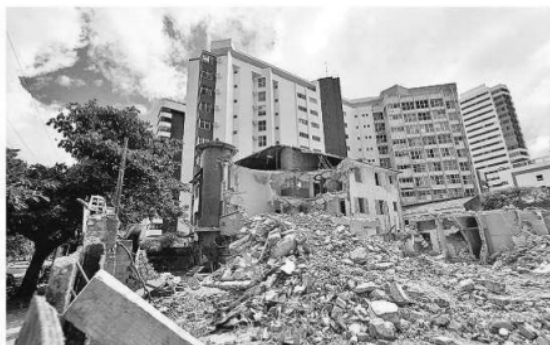
ESCOMBROS Parte do Edifício Caiçara, localizado na orla, foi derrubada em setembro de 2013
