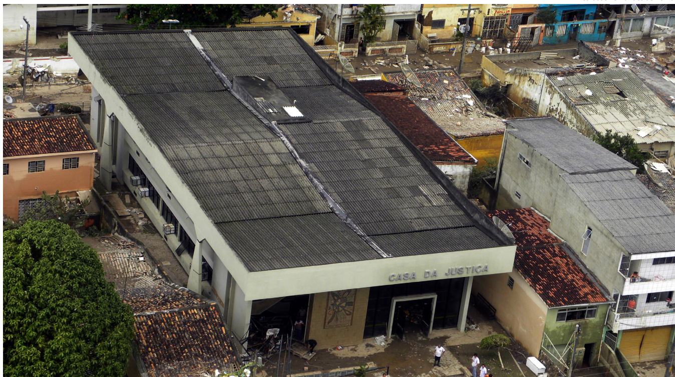
As chuvas de junho danificaram completamente a estrutura do Fórum Casa da Justiça Aníbal Bruno, em Palmares, além de milhares de processos
