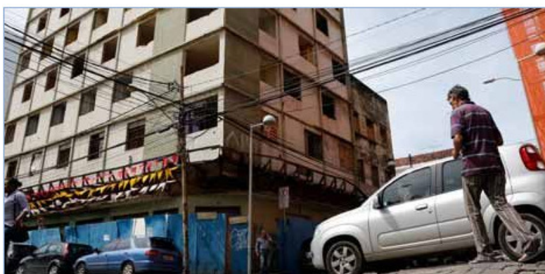
Pedaços da estrutura do prédio já desmoronaram
